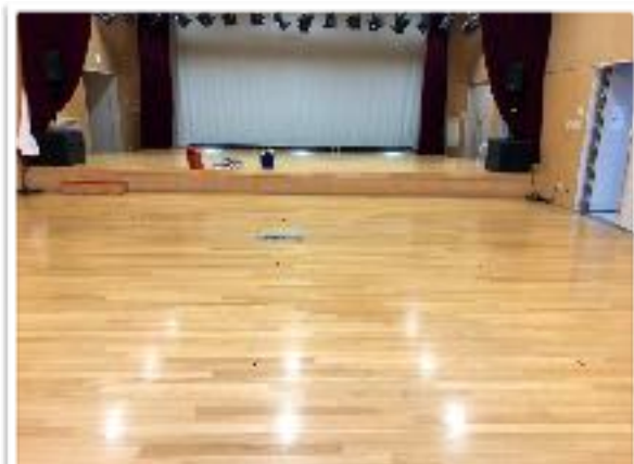
八広地域プラザ (床に目張りされています)
